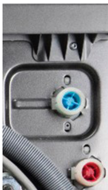
Entrada agua fría
